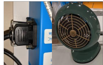
K1 Fan Relay & Fan
