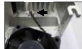
Fan power disconnection
