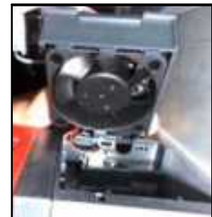
Fan power connection
