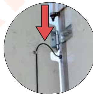
Proper Wiring Slack
