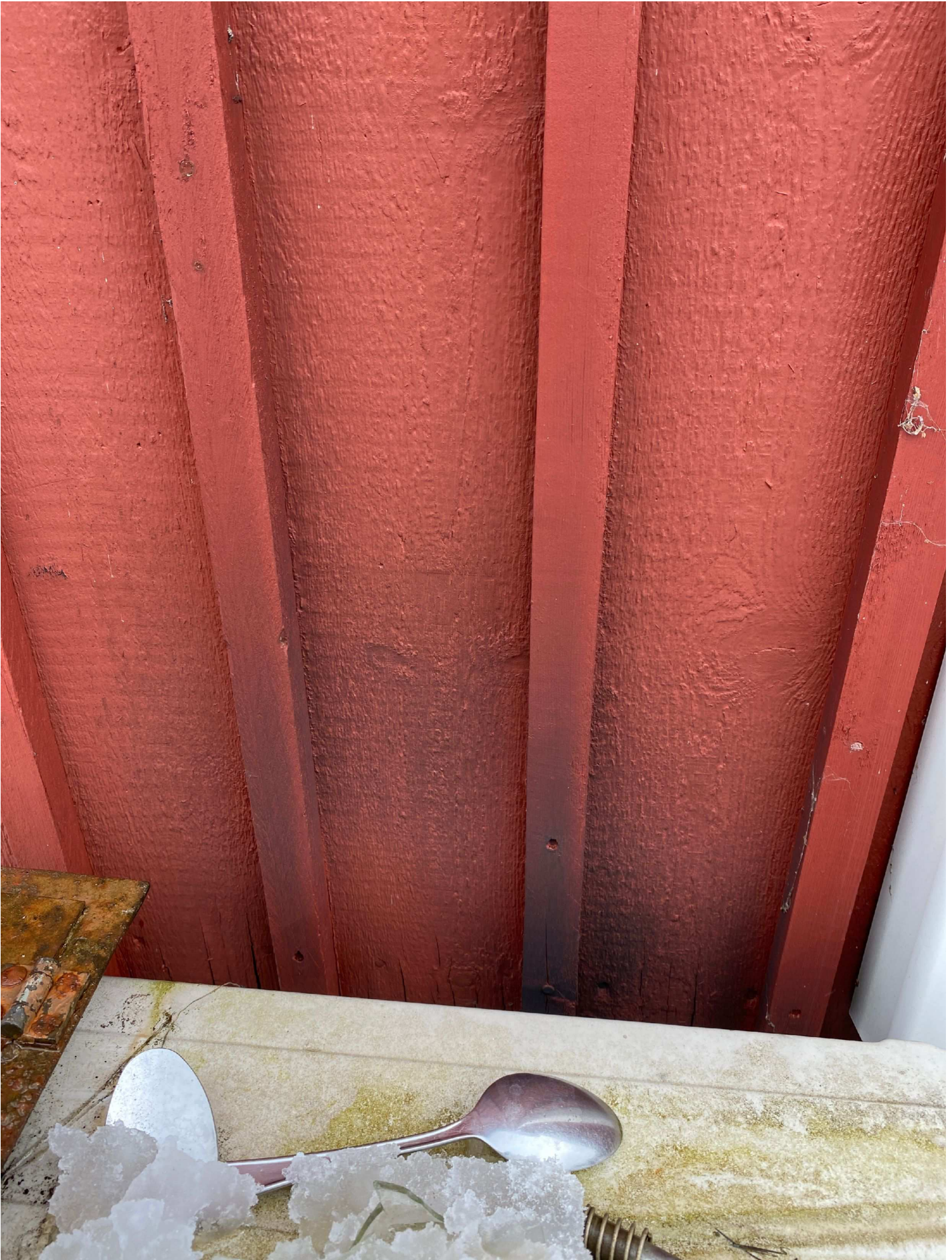
6. Bild taget av PA E. Nydén. Brandskadan syns på husväggen. Bild tagen ovanifrån, längs med husväggen.
