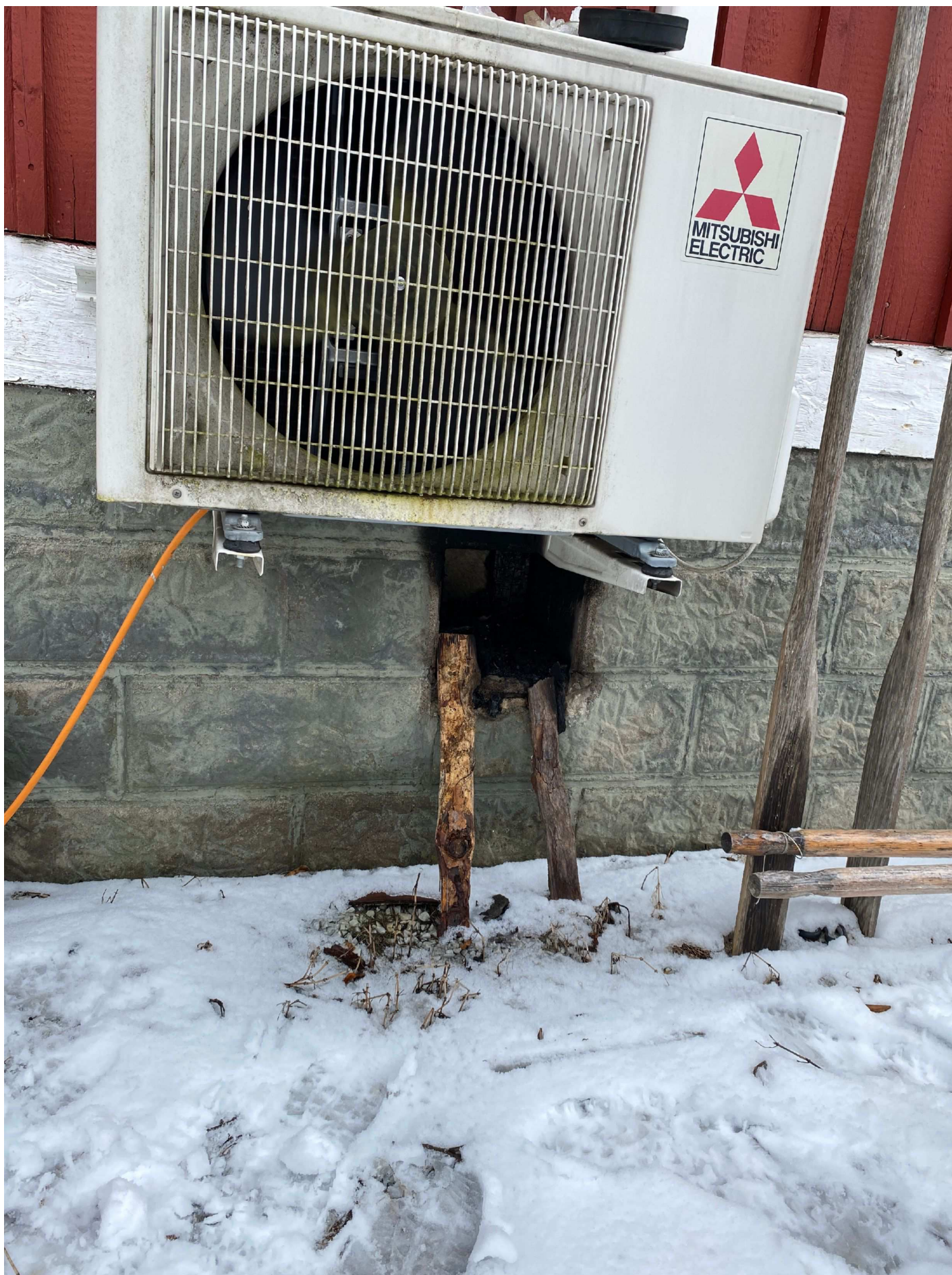
4. Bild taget av PA E. Nydén. Brandskadad syns på fasaden.
