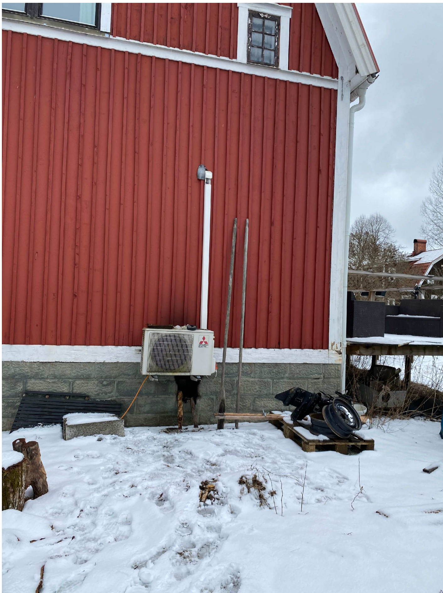
16. Översiktsbild taget av PA E. Nydén. Brandskadan syns under airconditionen på husväggen.
