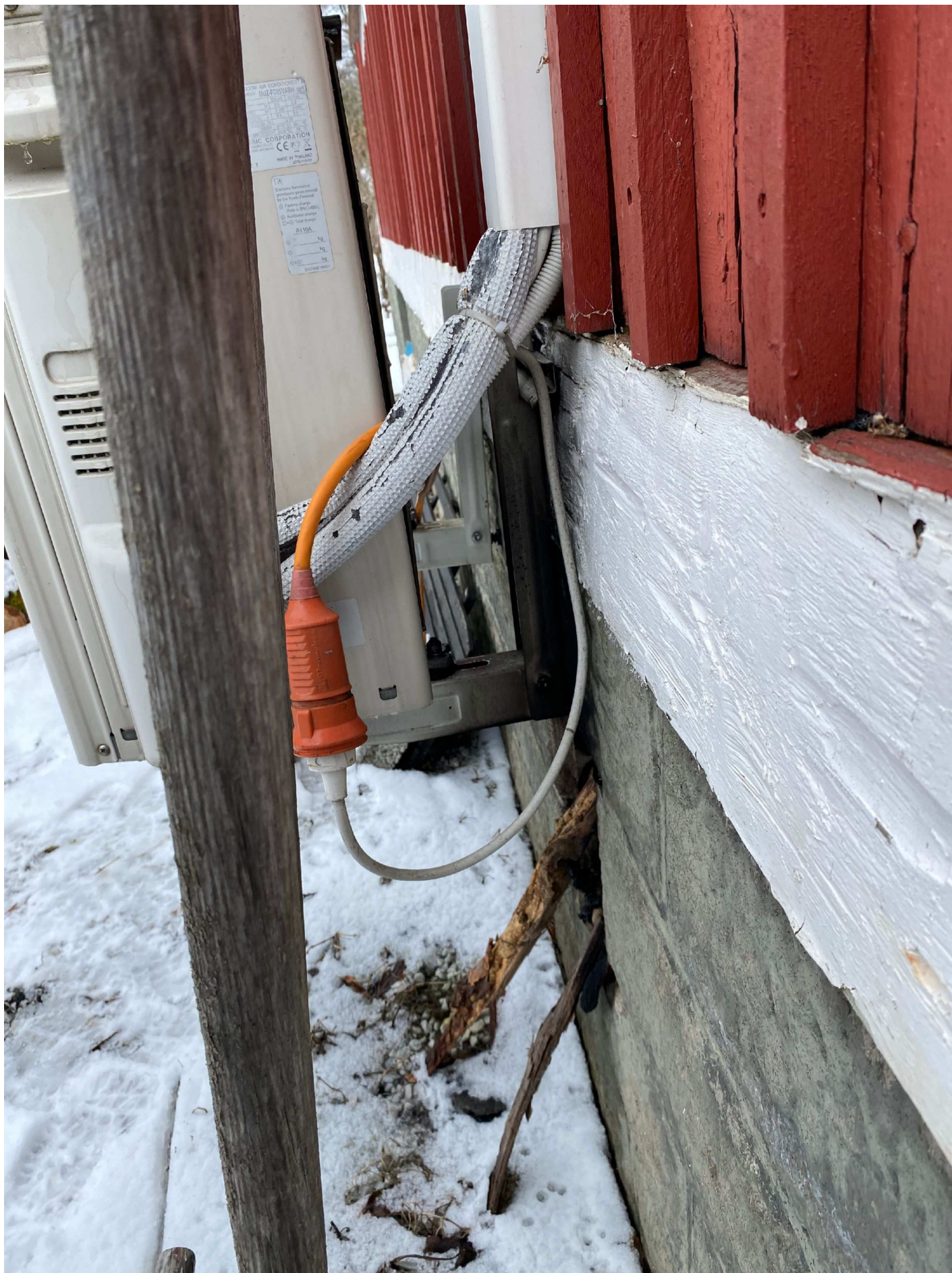
20. Bild taget av PA E. Nydén. Brandskadan syns på husväggen. Fotot är taget i riktning mot Korsvägen.
