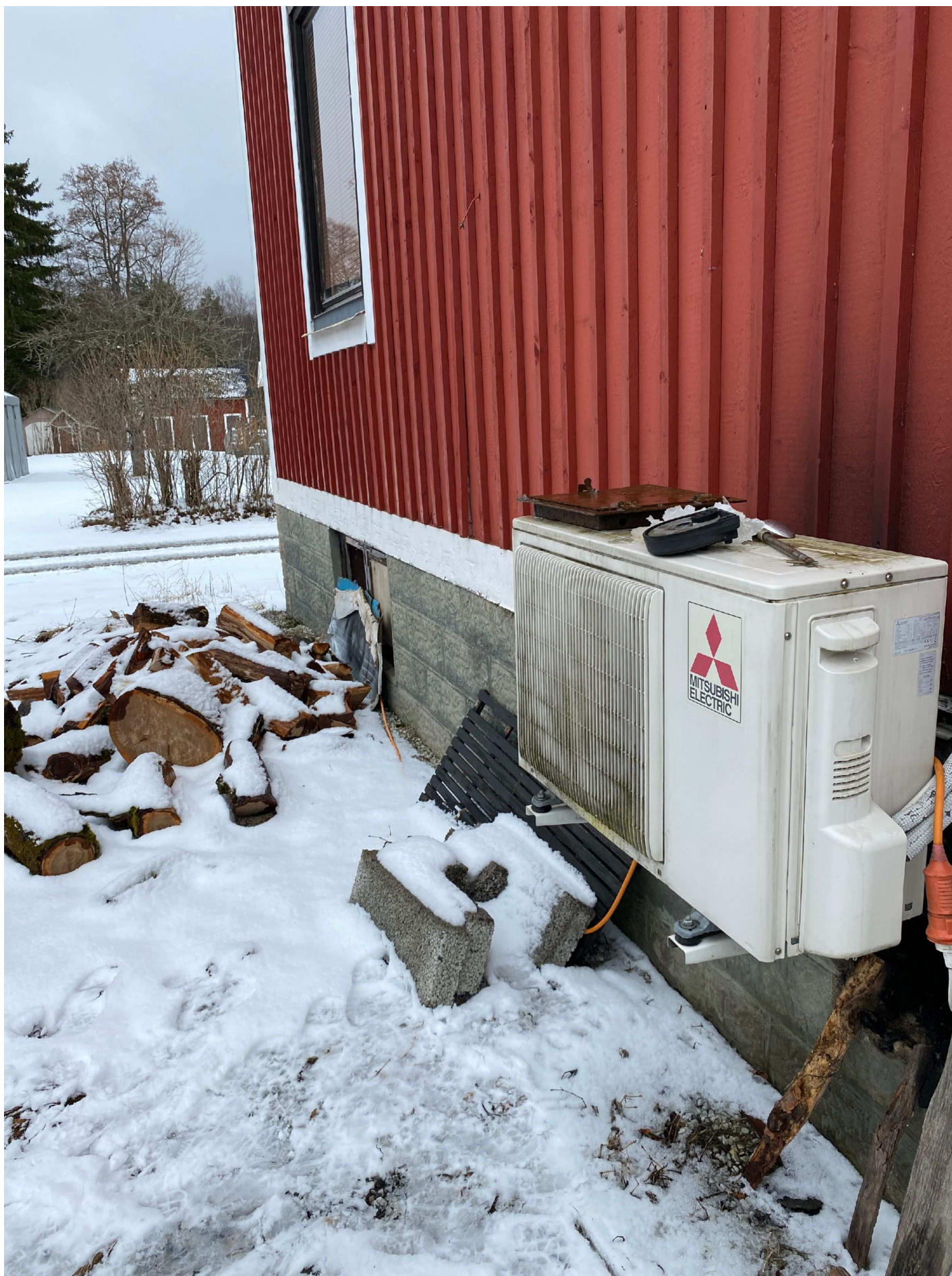
21. Bild taget av PA E. Nydén. Brandskadan syns på husväggen. Fotot är taget i riktning mot Korsvägen.
