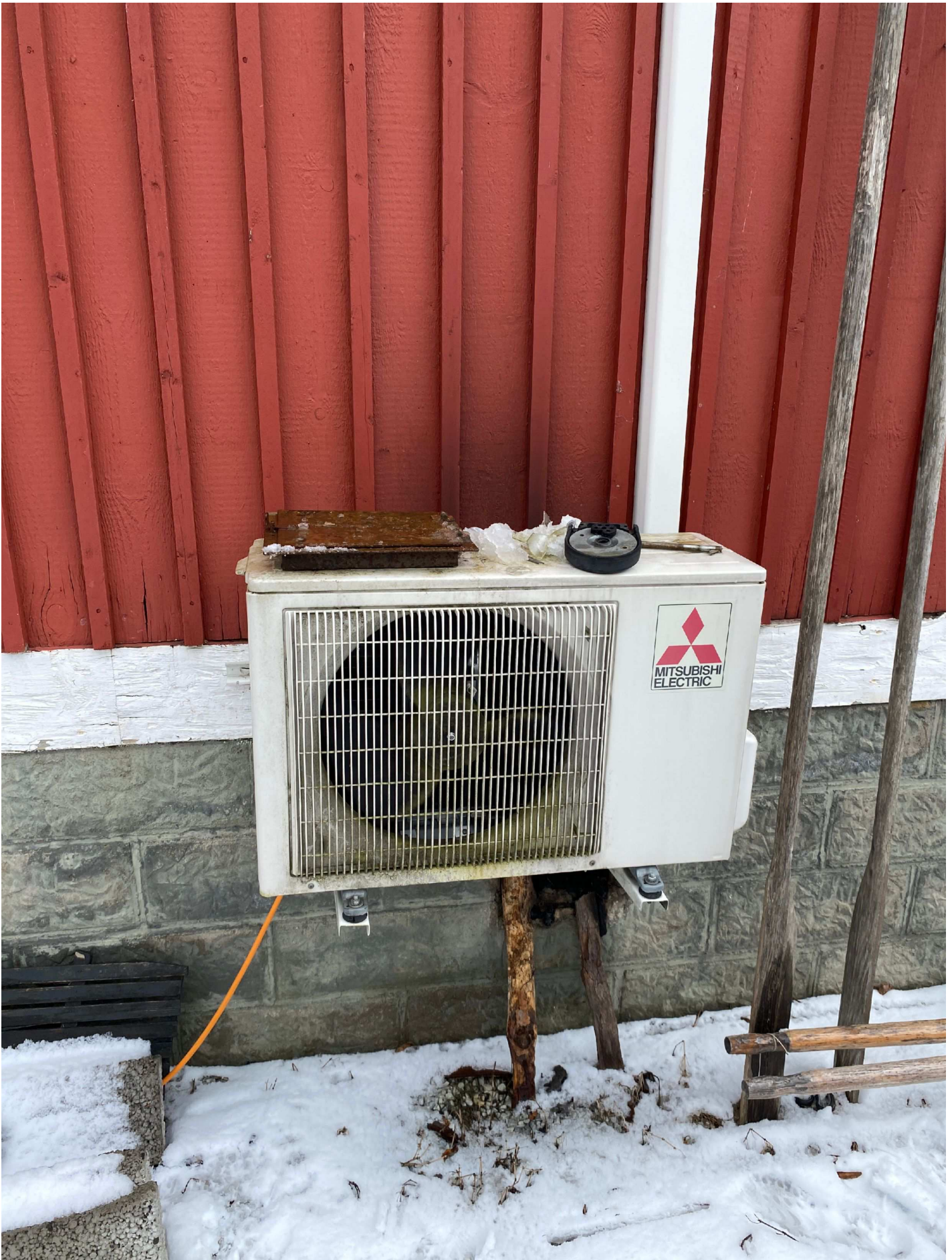
5. Bild taget av PA E. Nydén. Brandskadad syns på fasaden.
