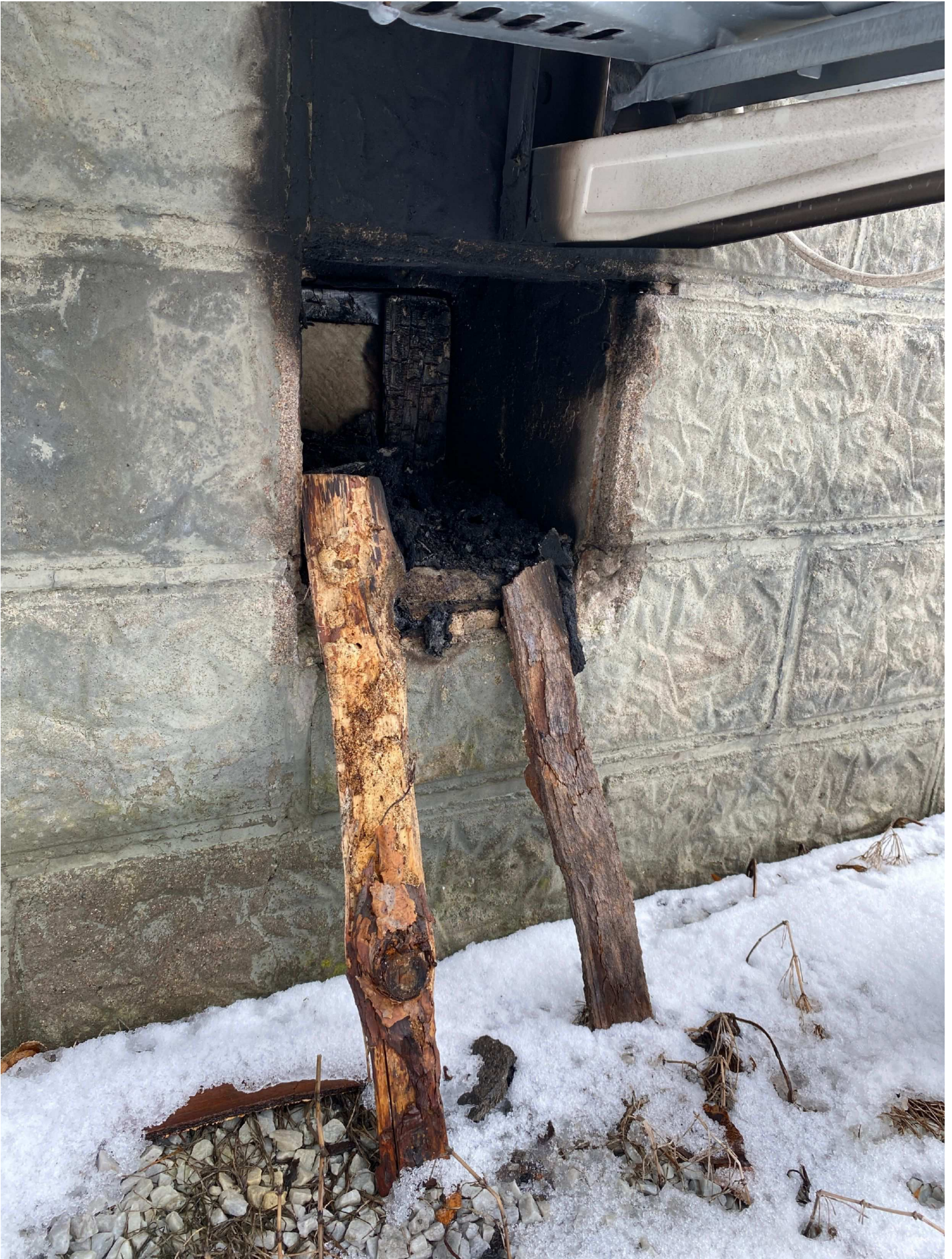
10. Bild taget av PA E. Nydén. Brandskadan syns på husväggen.
