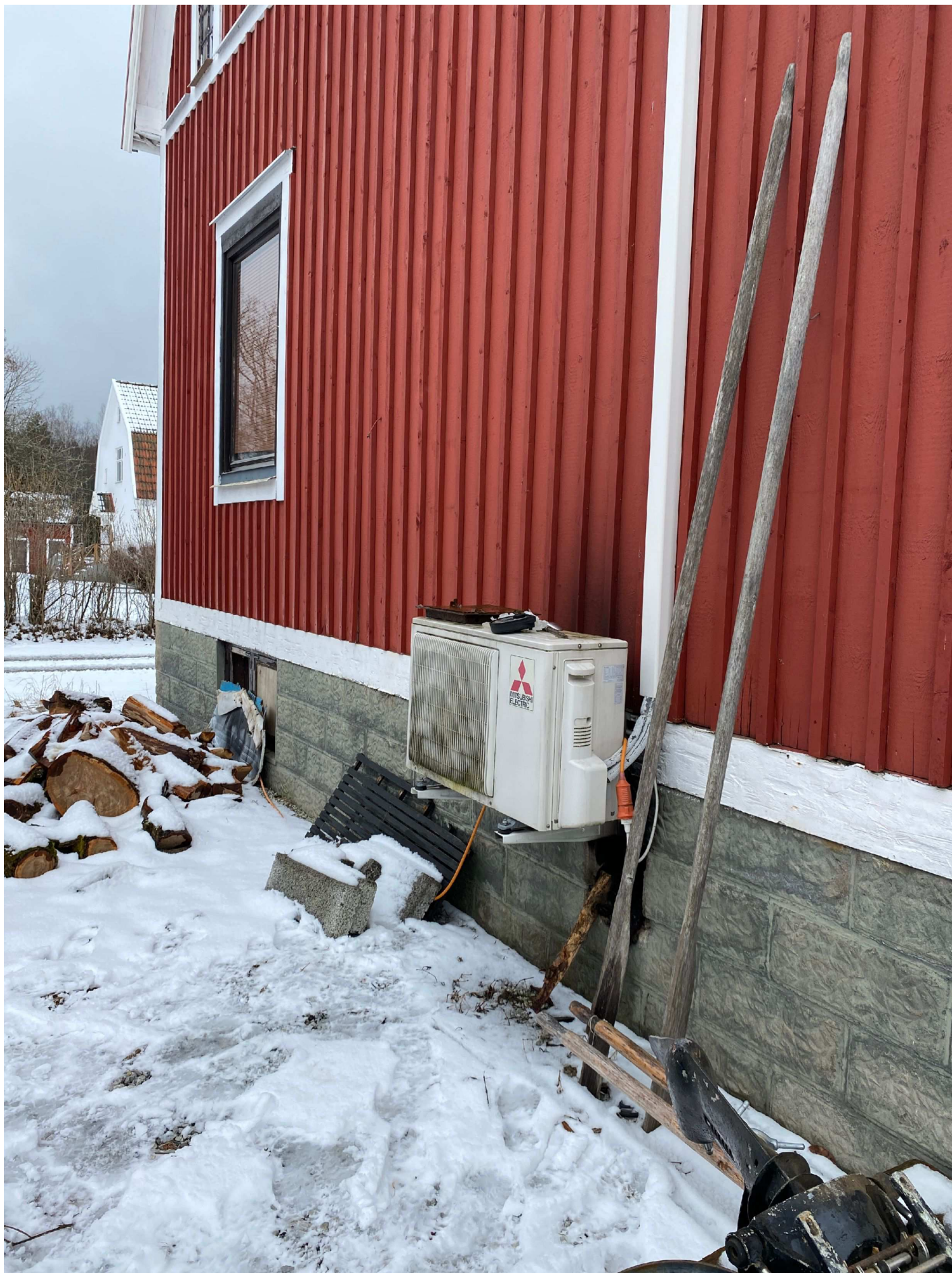
18. Översiktsbild taget av PA E. Nydén. Brandskadan syns under airconditionen på husväggen
