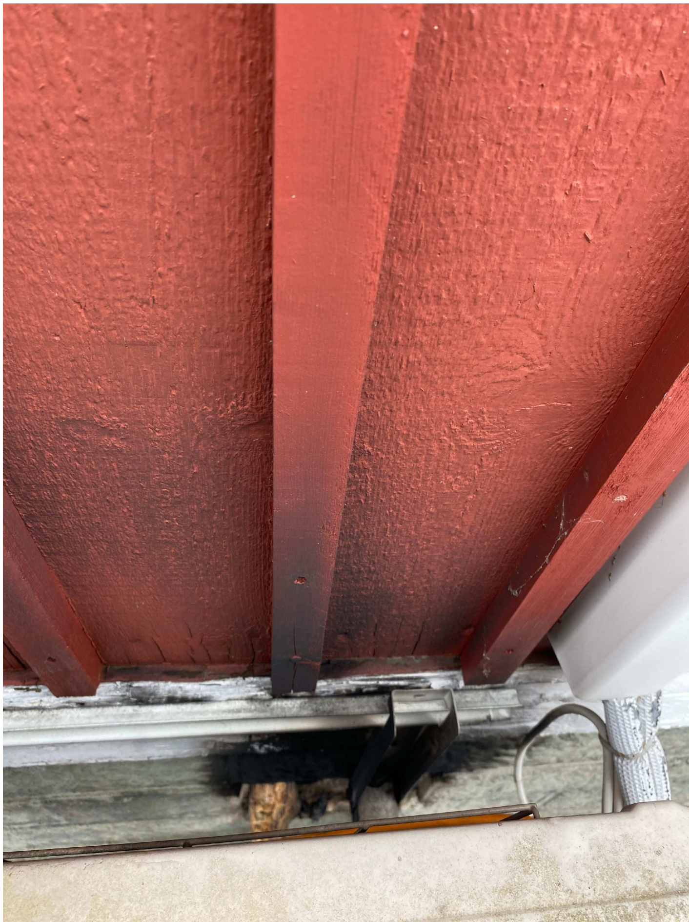
8. Bild taget av PA E. Nydén. Brandskadan syns på husväggen. Bild tagen ovanifrån, längs med husväggen.
