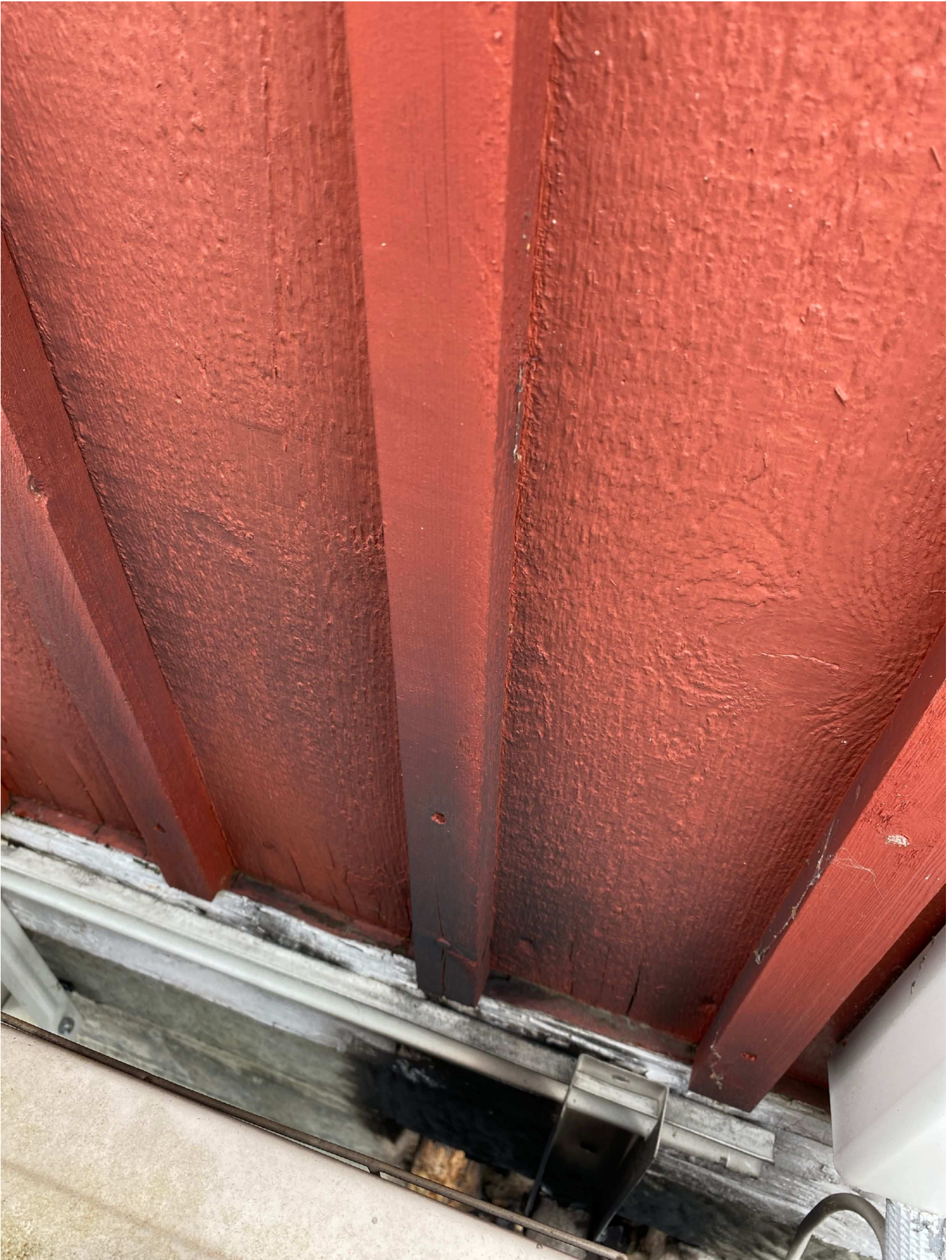
7. Bild taget av PA E. Nydén. Brandskadan syns på husväggen. Bild tagen ovanifrån, längs med husväggen.
