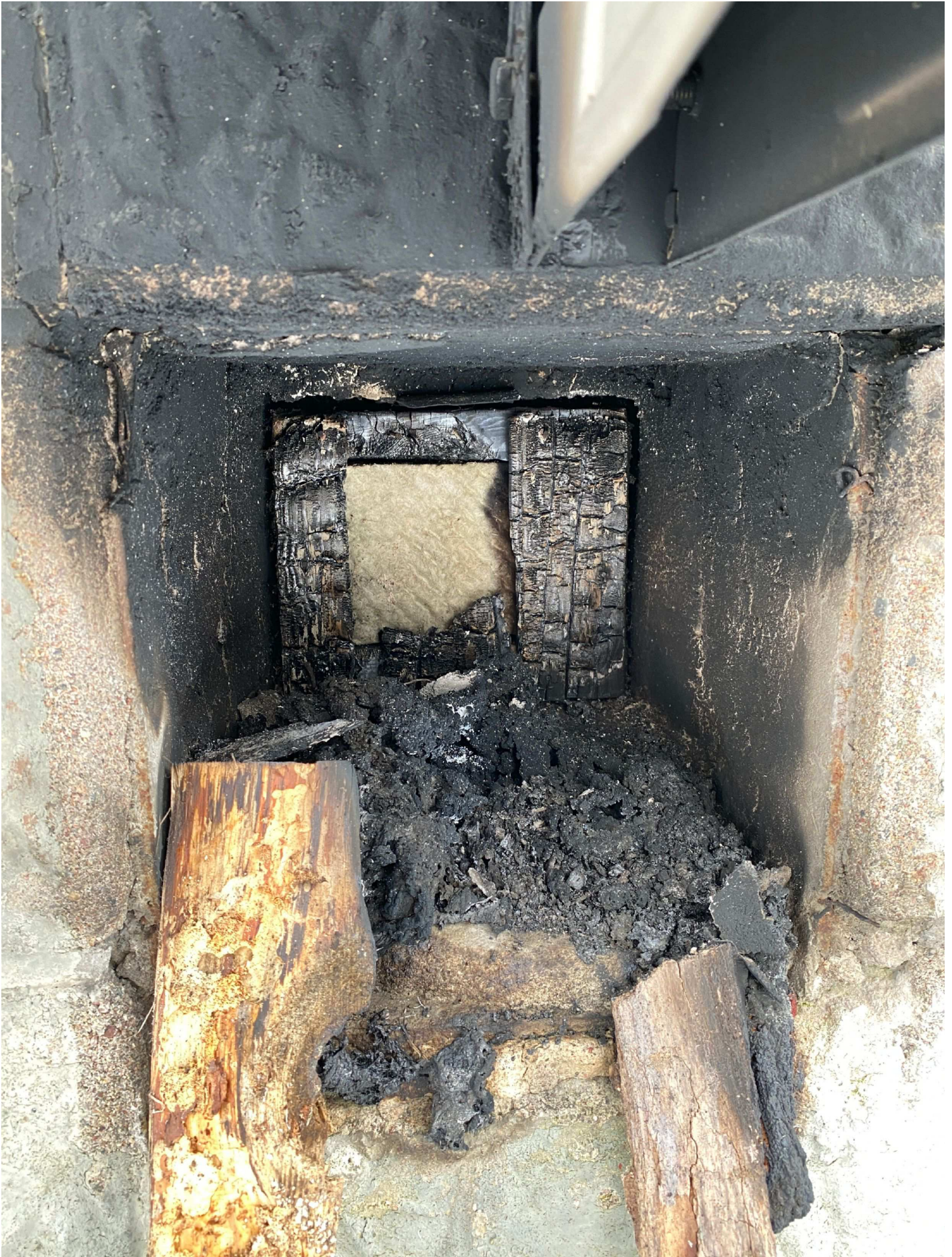
2. Bild taget av PA E. Nydén. Brandskadan på husväggen.
