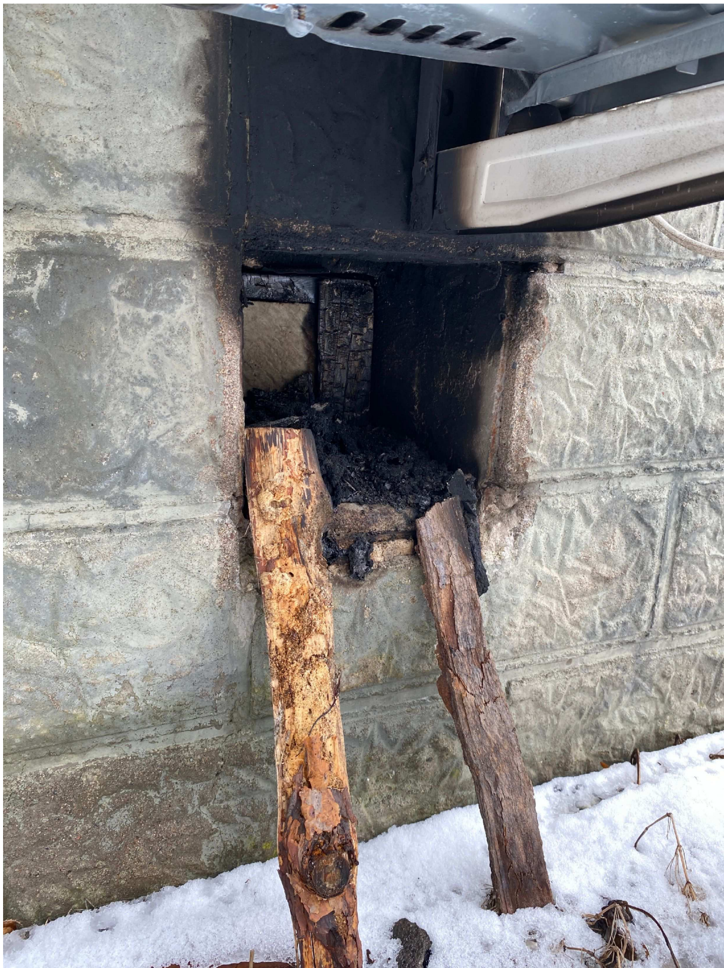
9. Bild taget av PA E. Nydén. Brandskadan syns på husväggen.
