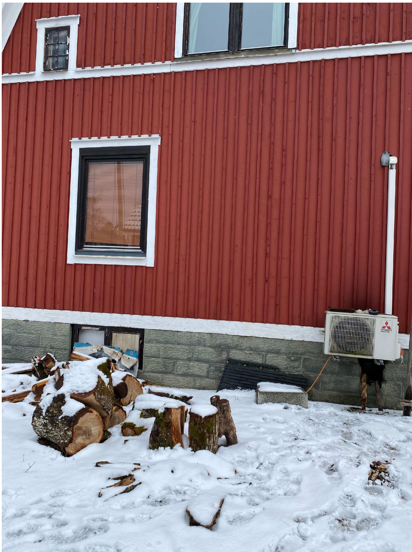
17. Översiktsbild taget av PA E. Nydén. Brandskadan syns under airconditionen på husväggen
