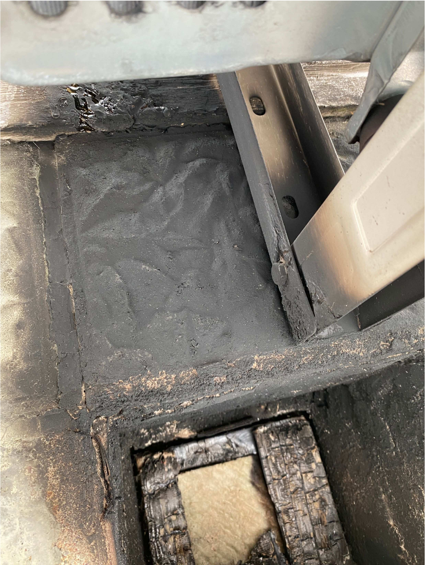
12. Bild taget av PA E. Nydén. Fotot taget underifrån i riktning mot hustaket. Brandskadan på husväggen.
