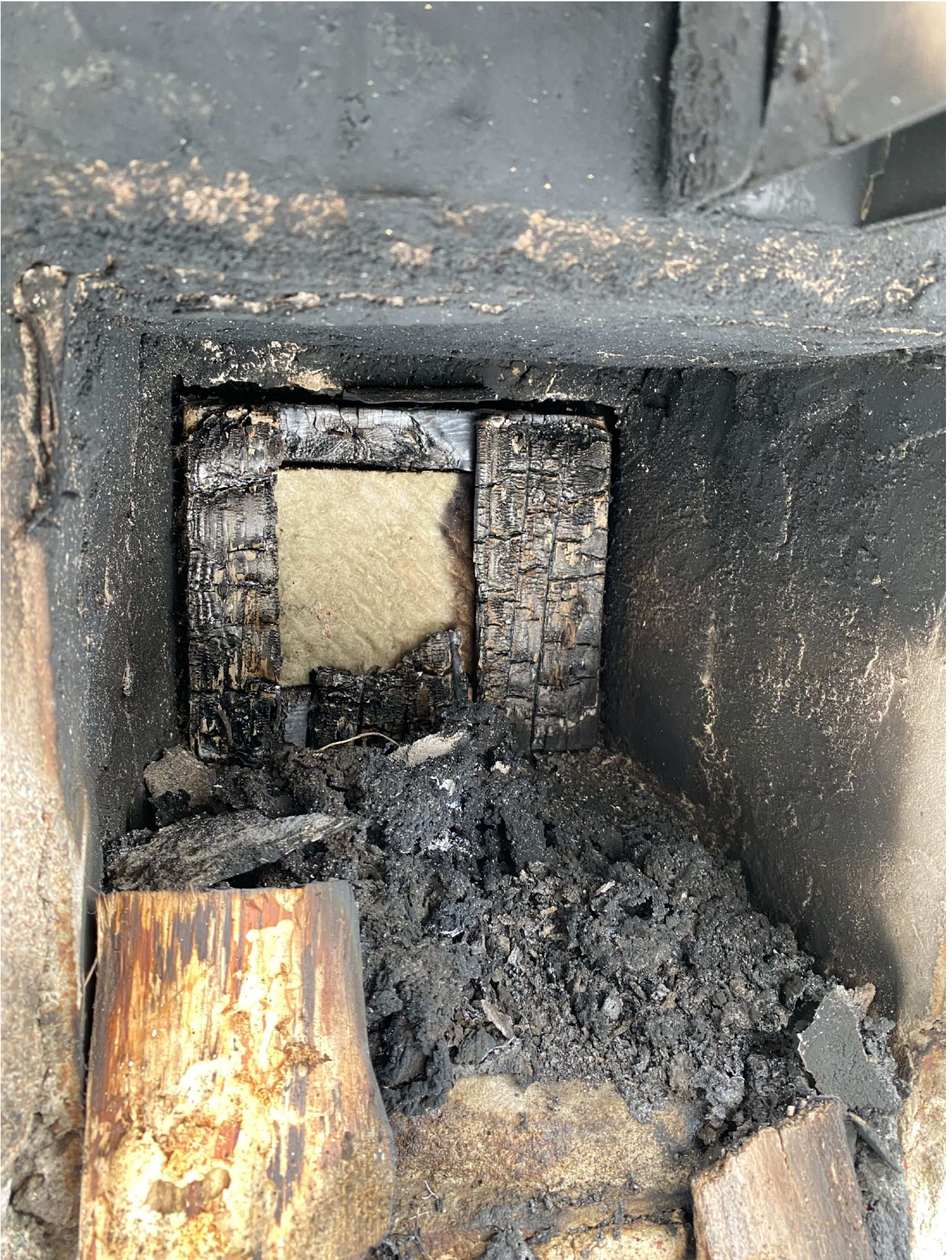
11. Bild taget av PA E. Nydén. Brandskadan på husväggen.
