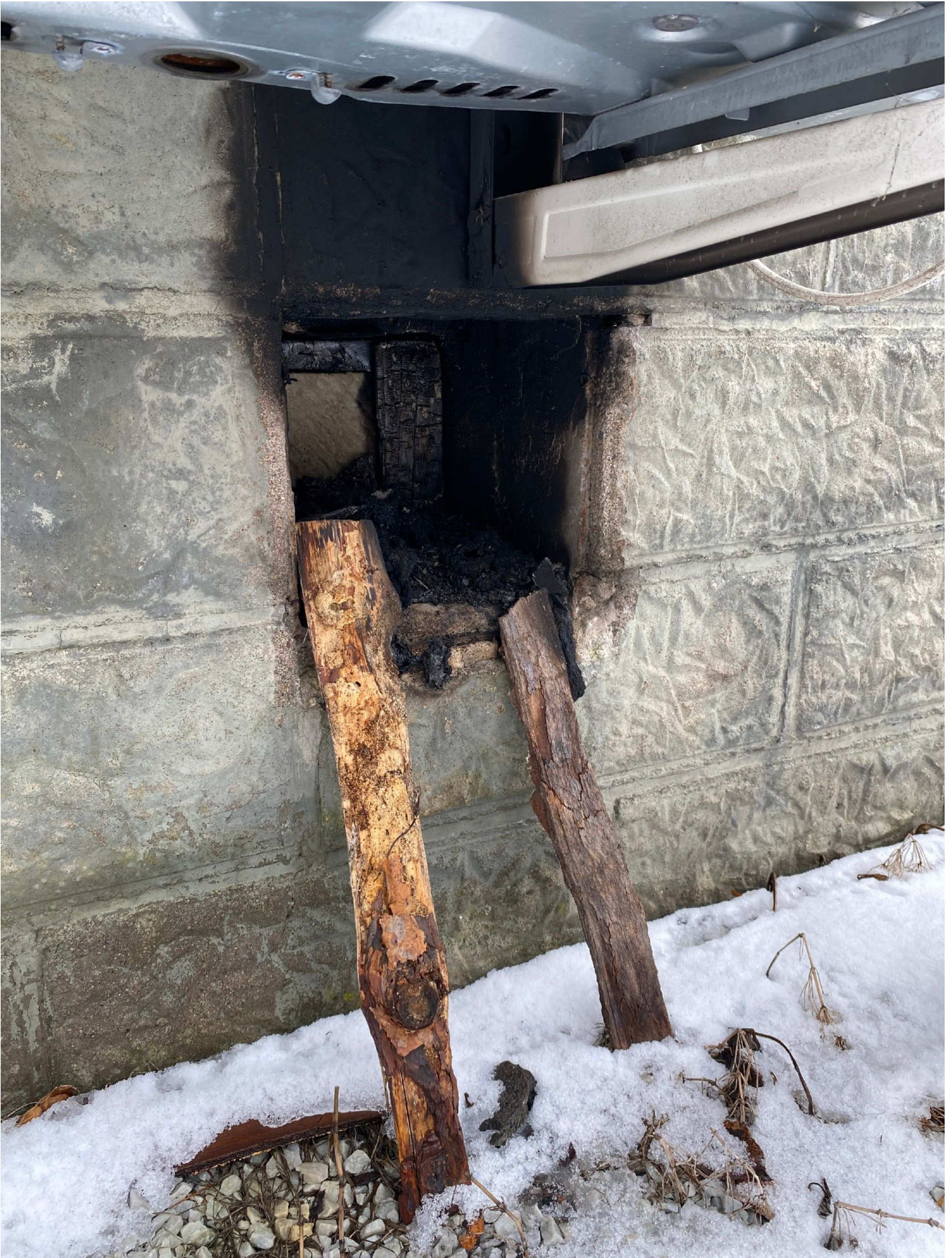
1. Bild taget av PA E. Nydén. Brandskadan på husväggen.
