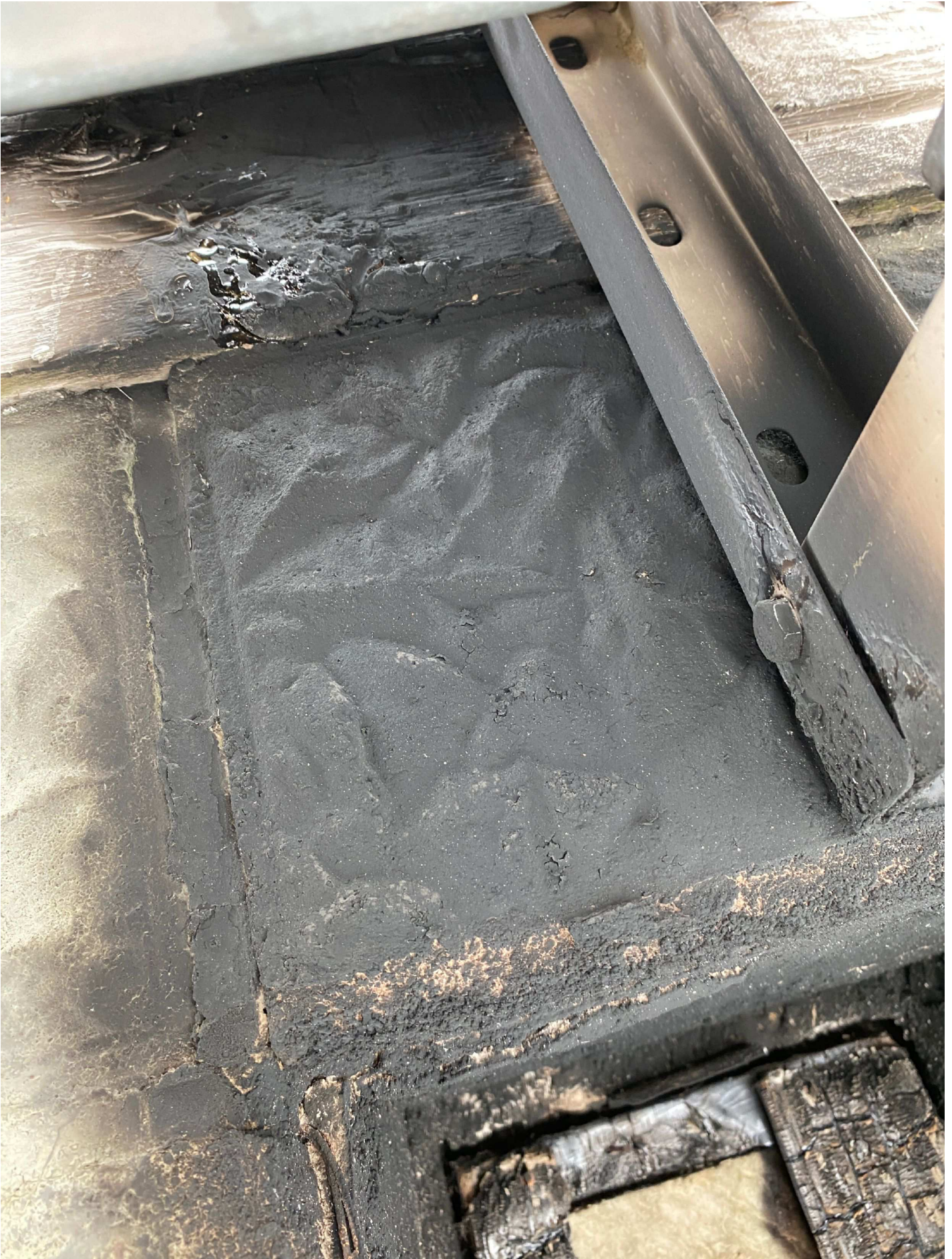
13. Bild taget av PA E. Nydén. Fotot taget underifrån i riktning mot hustaket. Brandskadan på husväggen.
