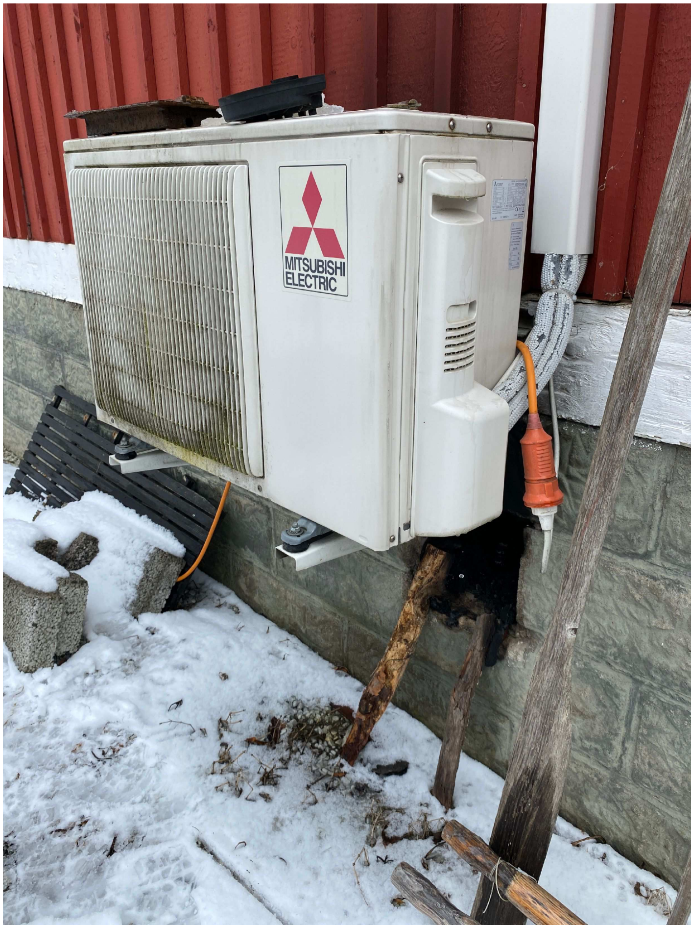
19. Bild taget av PA E. Nydén. Brandskadan syns under airconditionen på husväggen
